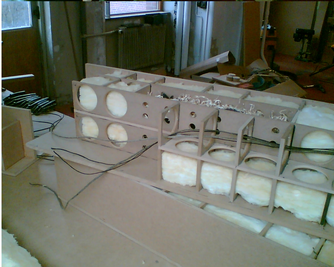
Kabelføringen til enhederne. (Toppen af kabinettet ser længere ud end meningen, dette er en fejl, som senere bliver skåret væk)
